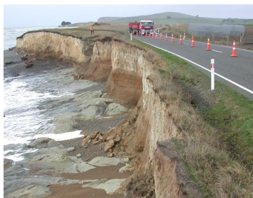
海岸侵蚀威胁岸边公路
